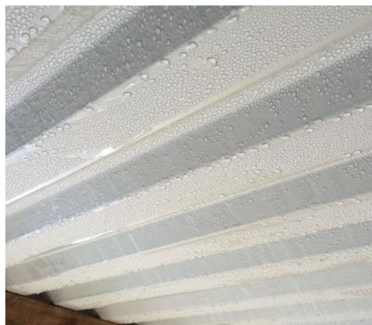
Obr. 1: Kondenzát na spodní straně nezateplené střechy
